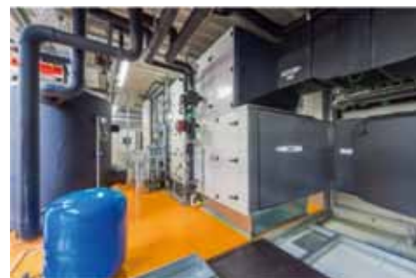
Technikebene mit Konditionierstrecke zur Versorgung der Messkammern
